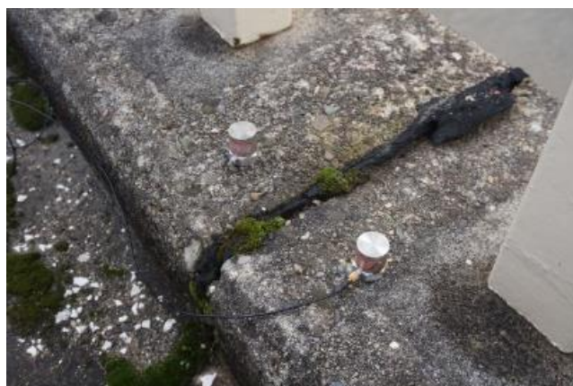
写真3-④-(1)-3.7 加速度センサの設置状況
