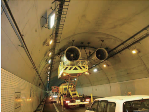
トンネル換気設備の構造検査
