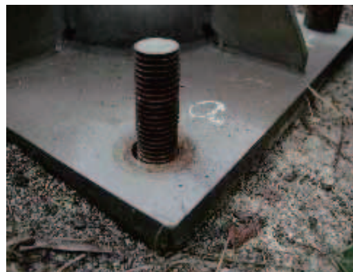
取付け用アンカーボルトの腐食、減肉化
