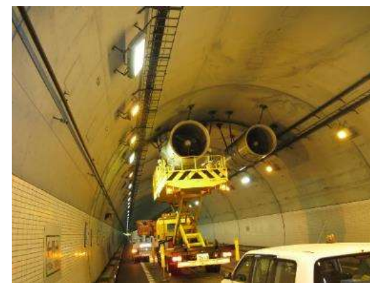
TN換気設備の構造点検
