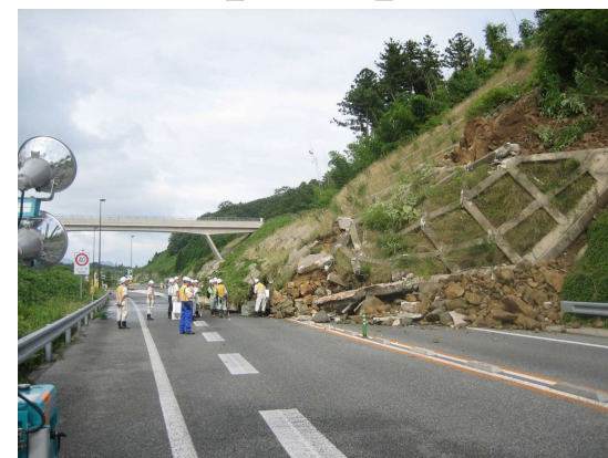
山陰自動車道切土のり面崩壊 【2007年、島根】
