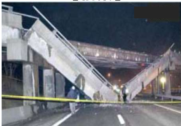
I-70コンクリート橋の落橋 【2005年、アメリカ】
