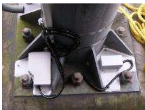
加速度計、傾斜計 (基部)
