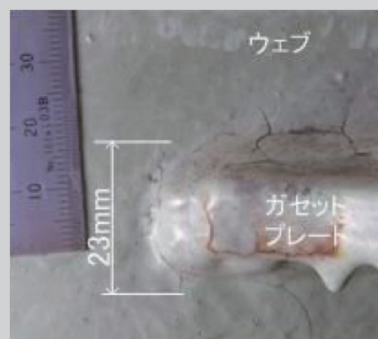
溶接部付近の亀裂
