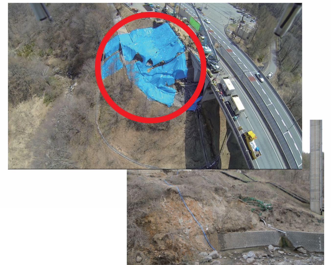
盛土のり面の崩落
