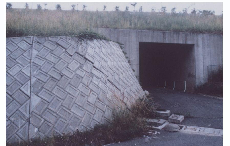
コンクリートブロック積のひび割れ、ずれ
