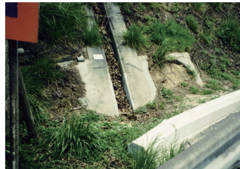
排水溝に土砂等が堆積
