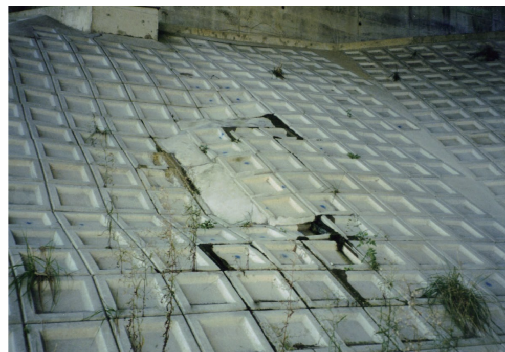
のり面保護工原地盤の沈下
