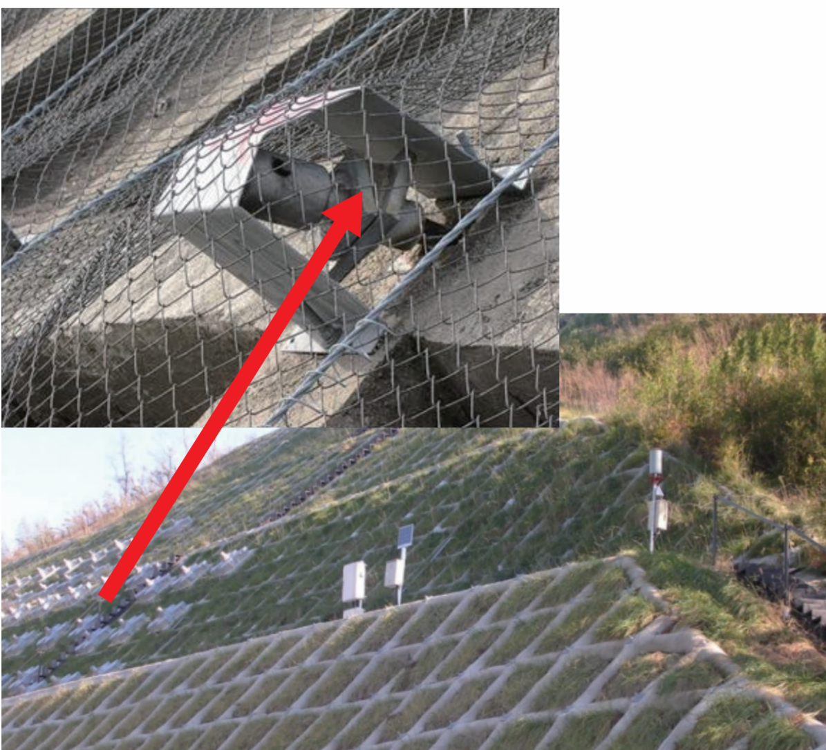
切土のり面のグラウンドアンカーの突出
