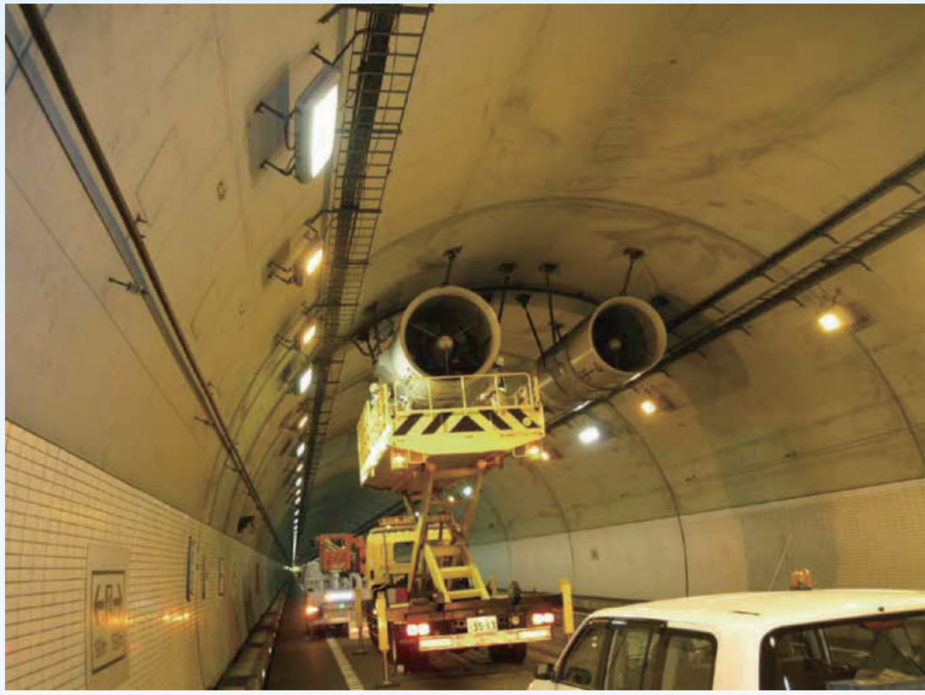
トンネル換気設備の構造検査
