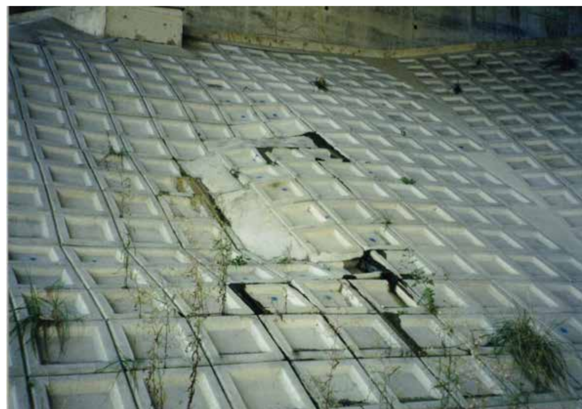
のり面保護工原地盤の沈下
