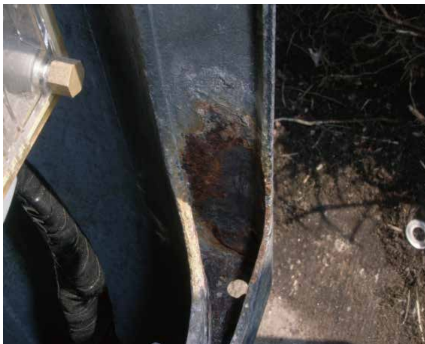
点検口下部に母材の腐食が見られる
