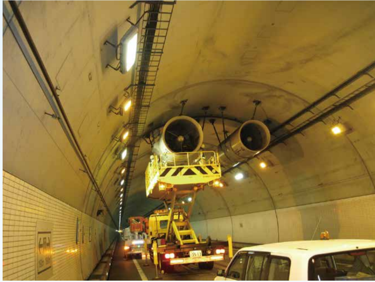
トンネル換気設備の構造検査
