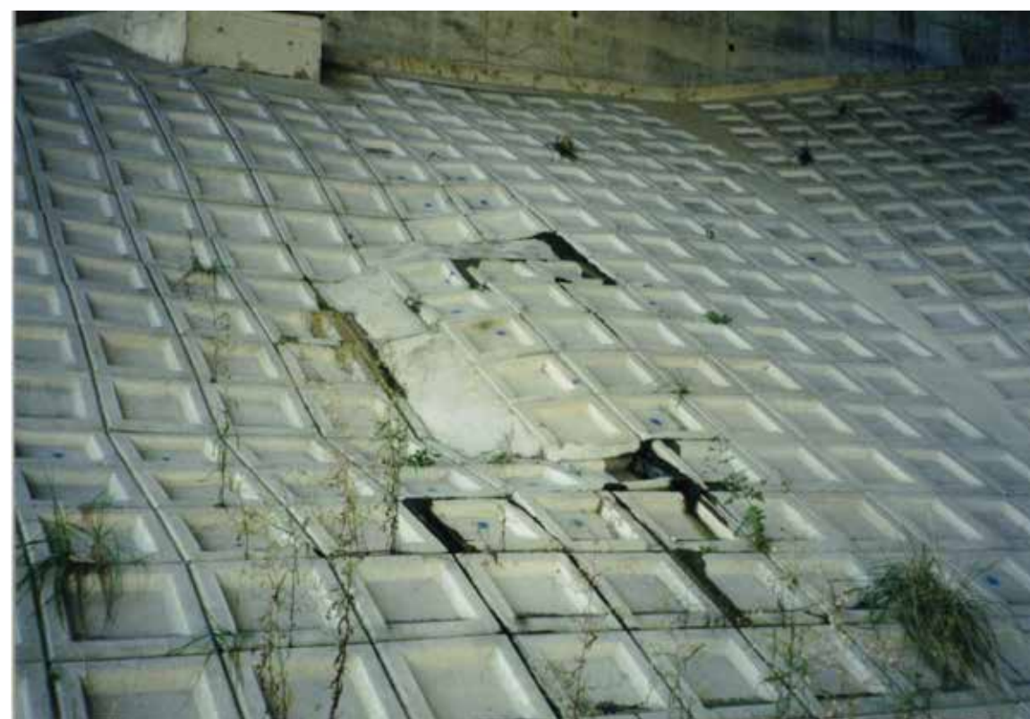
のり面保護工原地盤の沈下
