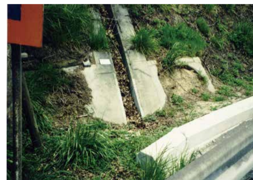
排水溝に土砂等が堆積
