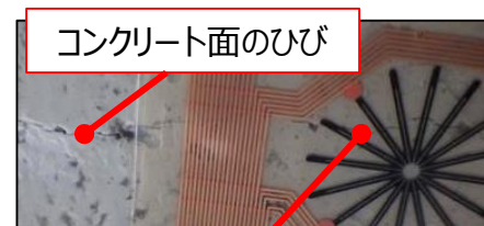
コンクリート面のひび センサ下のひび
