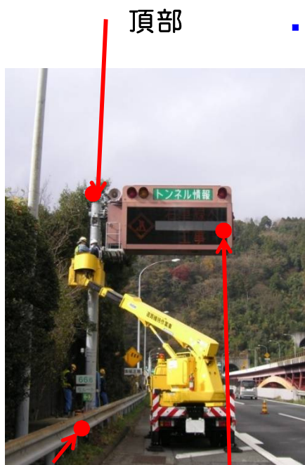
頂部 基部 内部 NEXCO中日本管内 A情報板
