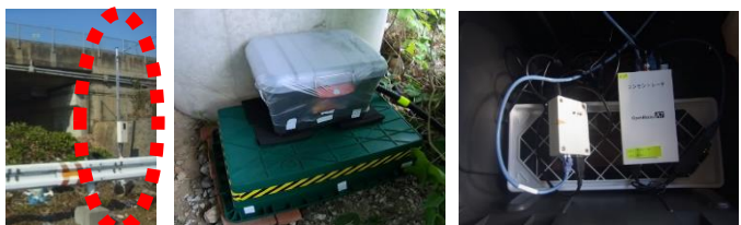
引込電柱 設置ケース外観 設置ケース内部
