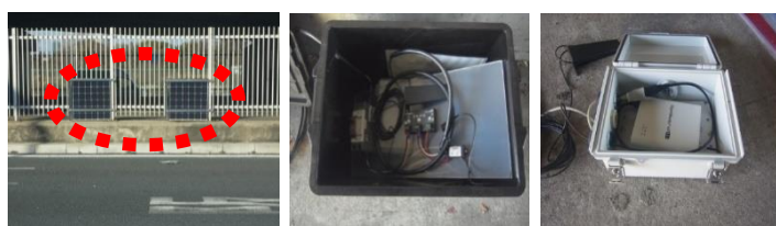
ソーラーパネル 設置ケース外観 設置ケース内部
