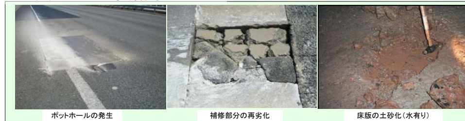
ポットホールの発生
