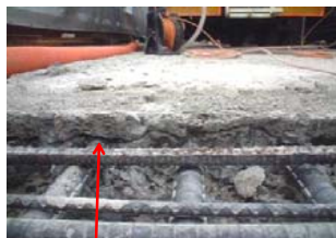
コンクリートのひび割れ
