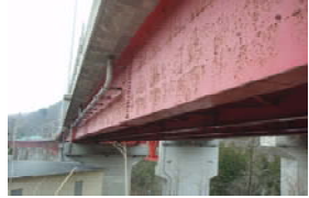
鋼桁の塗装劣化
