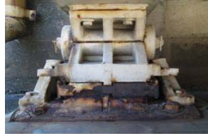
漏水による支承の劣化
