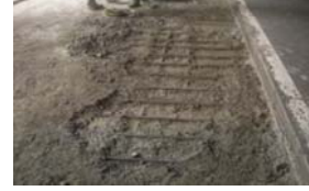
床版上面の劣化
