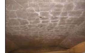
床版の疲労劣化
