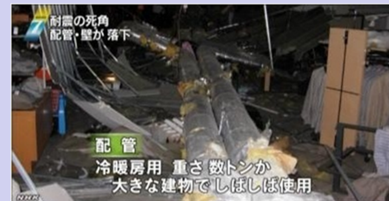
東日本大震災での配管落下による災害事例
