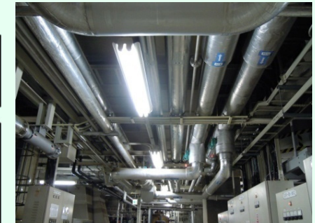
検討④: 配管設備環境の電磁波伝搬特性を実測
