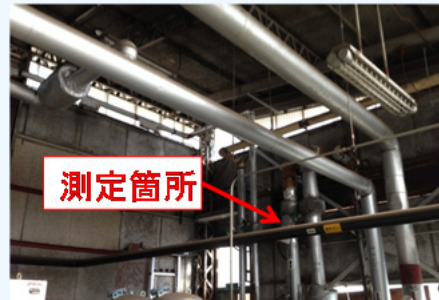
検討②: 稼働中のプラント設備の振動を実測
