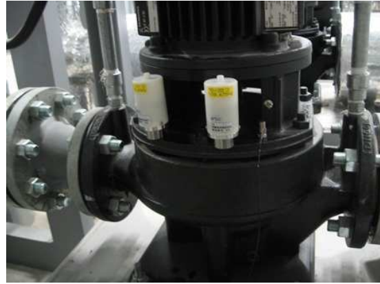
①-(3).6 実証実験ポンプのセンサ設置状況 病院施設
